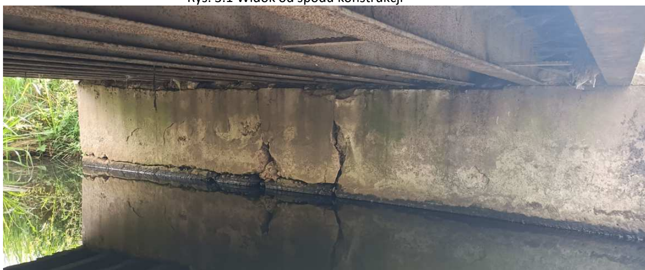
Rys. 3.2 Widok na spękany przyciótek betonowy
