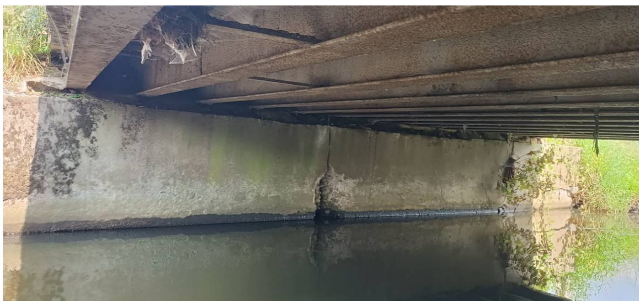
Rys. 3.3 Widok na spękany przyciótek betonowy
